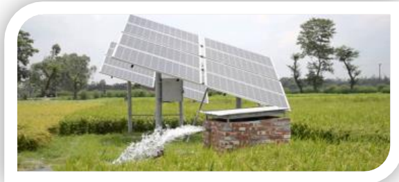
Riego con bombas solares en Arica y Talca.
