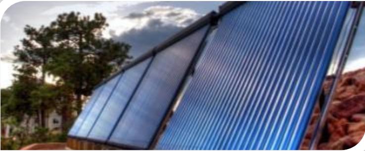
Calentamiento de agua Panales solares térmicos
